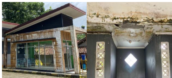
Gambar 2. Foto Fasilitas yang sudah rusak di Situ Sanghyang.
